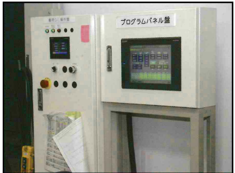
▲粉体塗装の設定はプログラムパネル盤で操作
